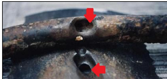
Figure 12 – Corrosion pits in the water pipelines Рус. 12 – Коррозионные питтинги на трубе водопровода Slika 12 – Korozivni pitovi u vodovodnim cevima
